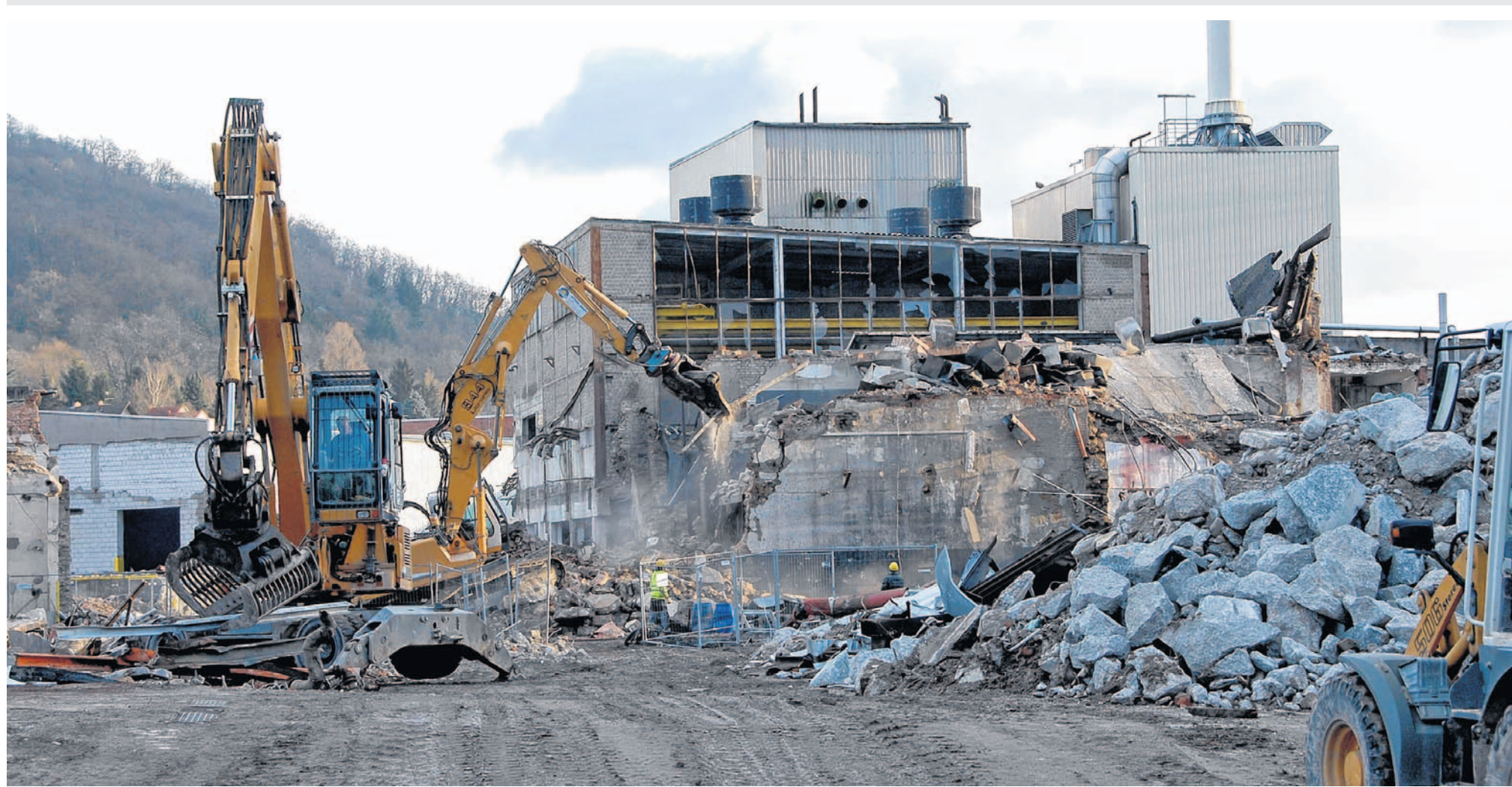
Bis spätestens Ostern soll die ehemalige Papierfabrik Euler komplett abgerissen sein. Der strenge Winter wirbelte auch hier den Zeitplan durcheinander.
