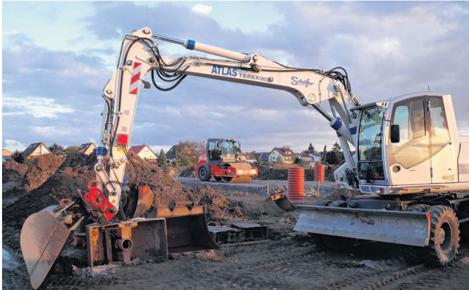
Rasch gehen die Arbeiten im Neubaugebiet „Lichter Fleck“ voran. Die unterirdischen Versorgungsleitungen sind bereits verlegt.
